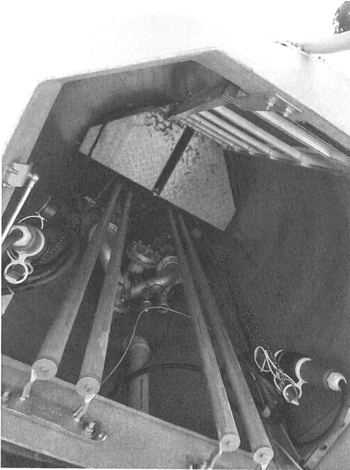
Linjapumppaamon kaivo-osa sisältä
